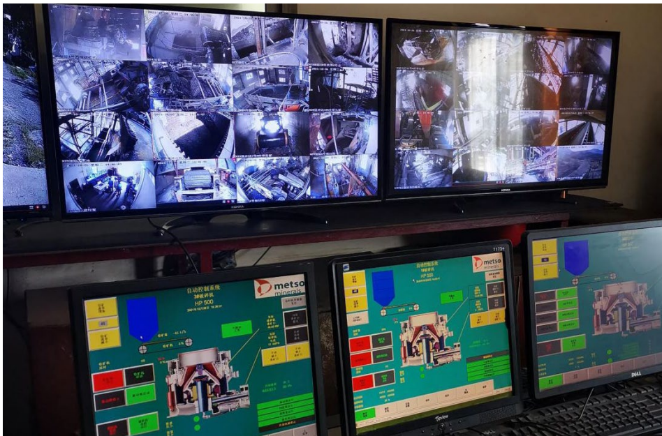
集中控制系统监控室
