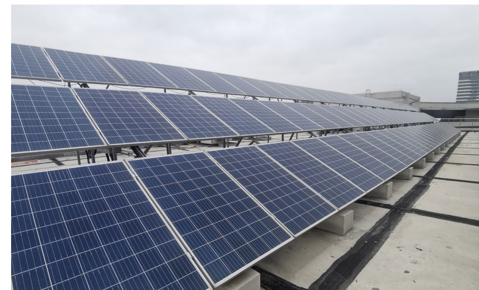
宝应吾悦广场太阳能光伏板
