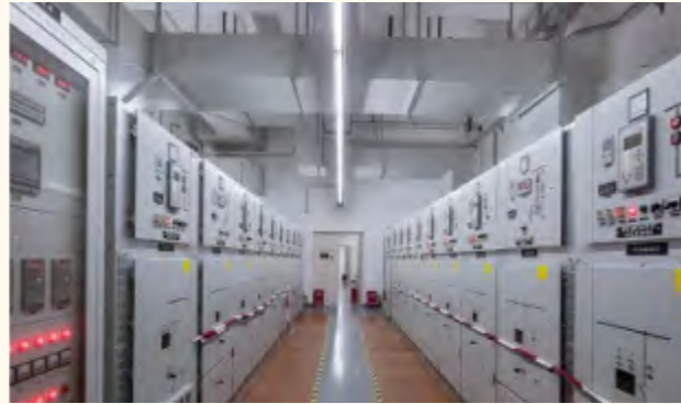
▲ 上海金桥托管机房
