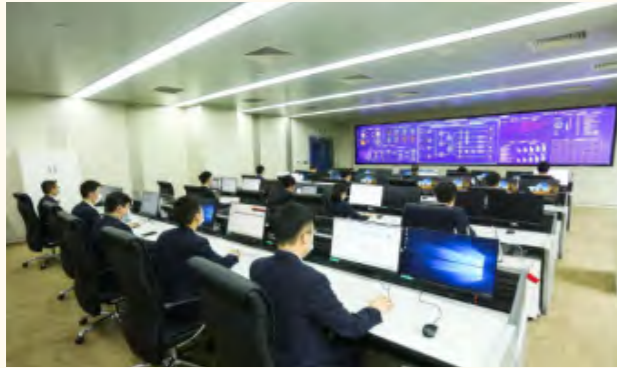
▲ 新大楼数据中心机房监控室
