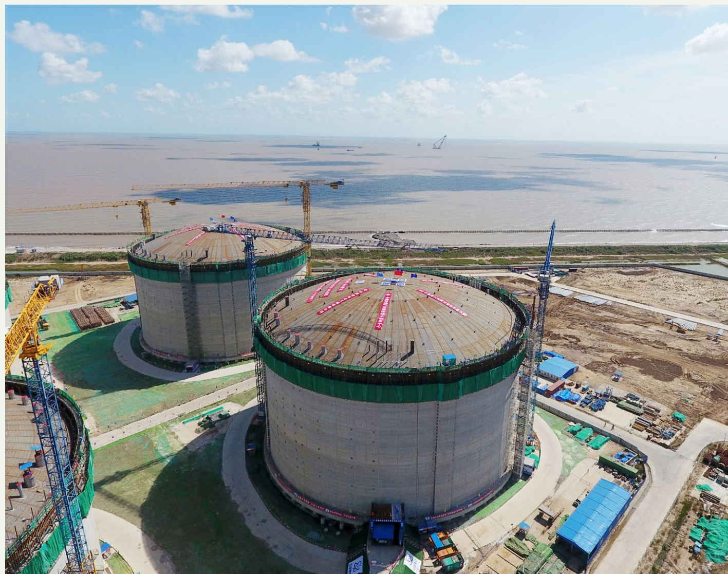
江苏滨海 LNG 项目
