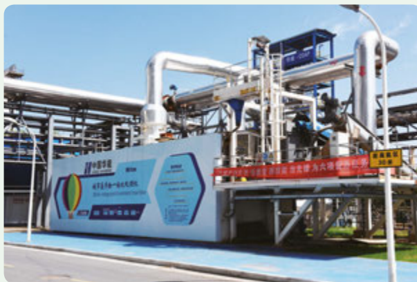
城市废弃物前置干燥炭化处理技术示范平台
