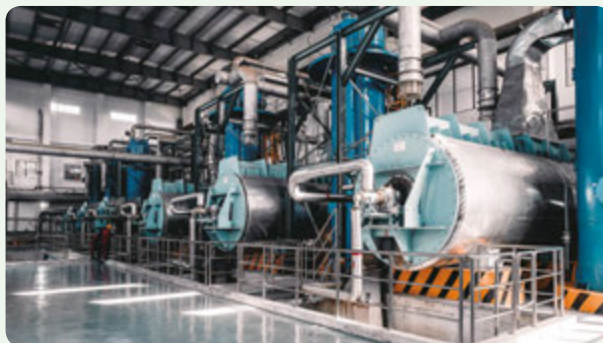
污泥耦合发电项目
