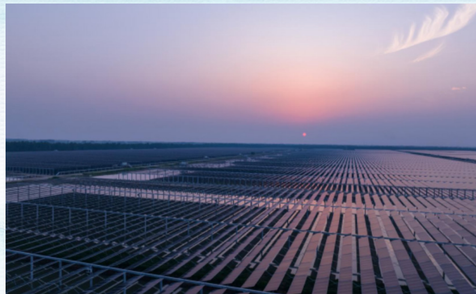
图：通威股份“渔光一体”项目
