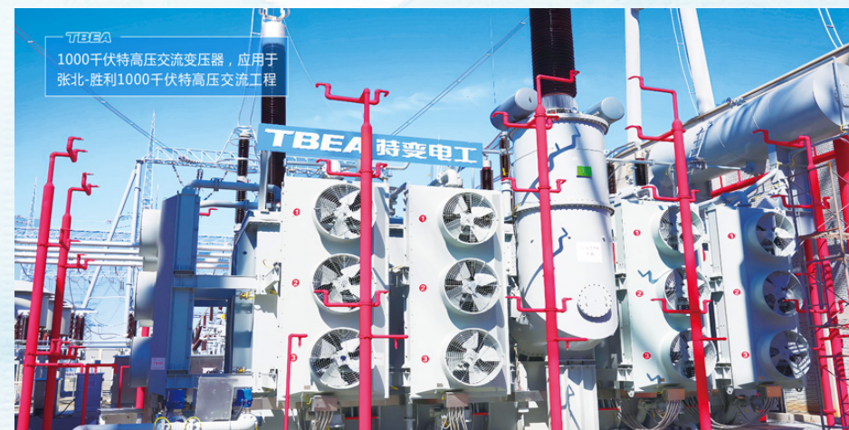
图：1000 千伏特高压交流变压器，应用于张北 - 胜利 1000 千伏特高压交流工程
