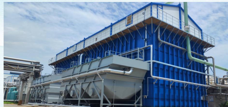
图：民丰特纸与维尔利公司合作建设的污水生化处理项目
